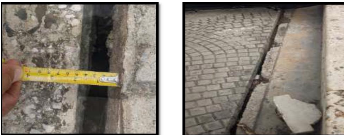
Figure 23. Agrietamiento paralelo a la estructura evidente en el parqueadero
