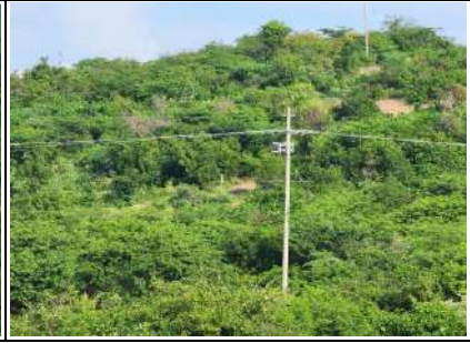
LIENAS DE ALTA Y MEDIANA TENSIÓN
